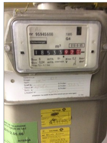
Compteur de gaz
